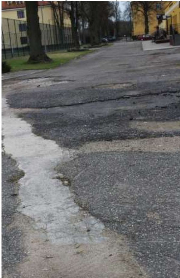
Fot. 9. Przykład problemu w zakresie stanu technicznego dróg na obszarze pokoszarowym
