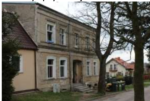
Fot. 4. Budynek mieszkalny w złym stanie technicznym przy ul. Orlej 28
